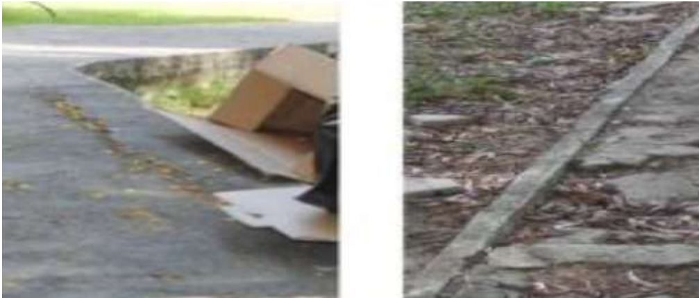
Figura 2 - Fotos de calçamento sem manutenção e buracos da UFES
